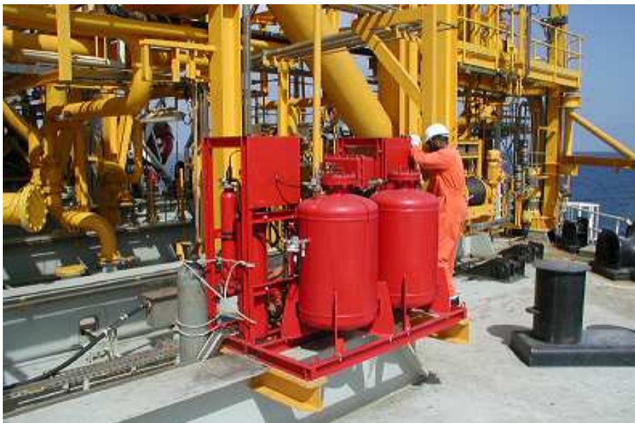
Réservoir 2x400 kg azote NFPA 17 (ATEX)
