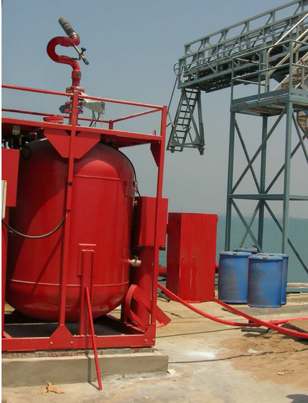
Réservoir 2000 kg avec plate forme pour opérateur
